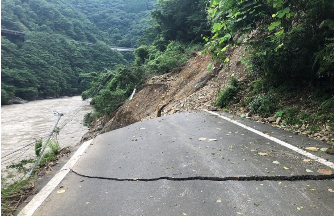
五木村村道川辺川線（被災状況）
