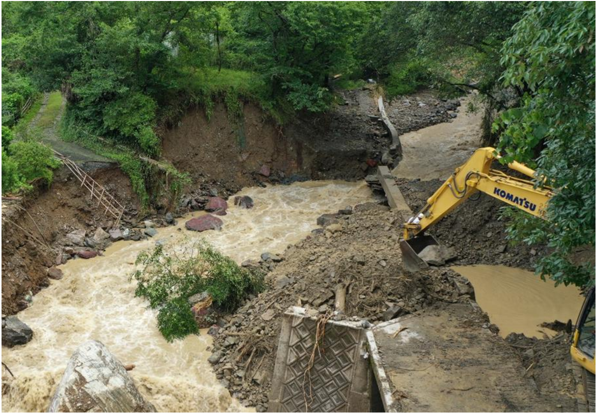
湯前町牧良線（被災状況）
