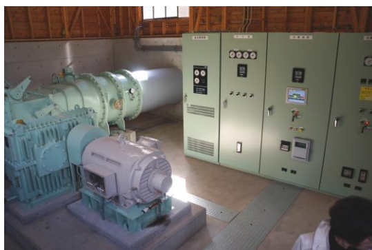
法定点検後の発電室
