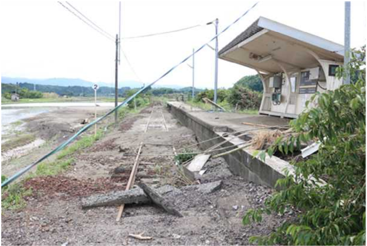
相良村川村駅 かわむら （被災状況）
