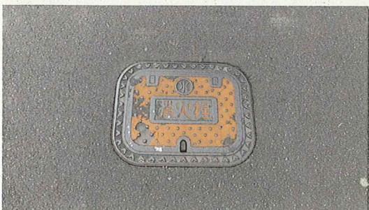
道路上の消火栓 (西谷)
