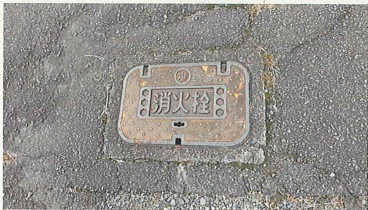
道路上の消火栓 (小鶴)
