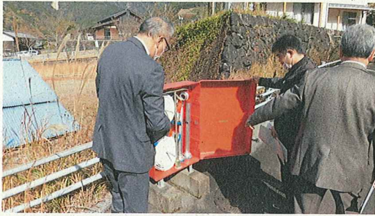
消火栓BOX (頭地)
