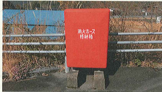
消火栓BOX (頭地)
