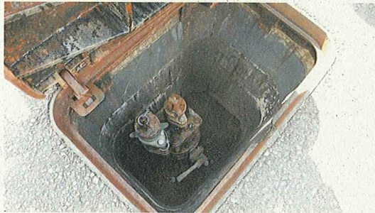
歩道にある消火栓 (頭地)
