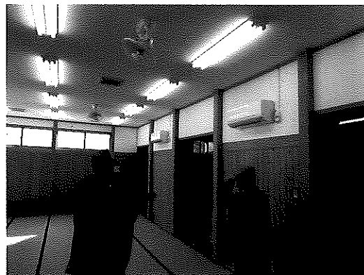
新設したエアコン 2 基
