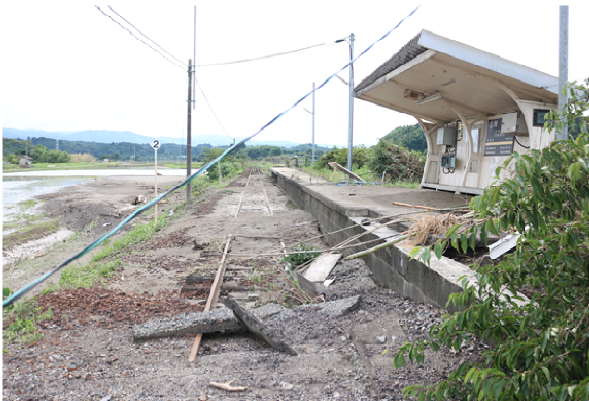
相良村川村駅 (被災状況)
